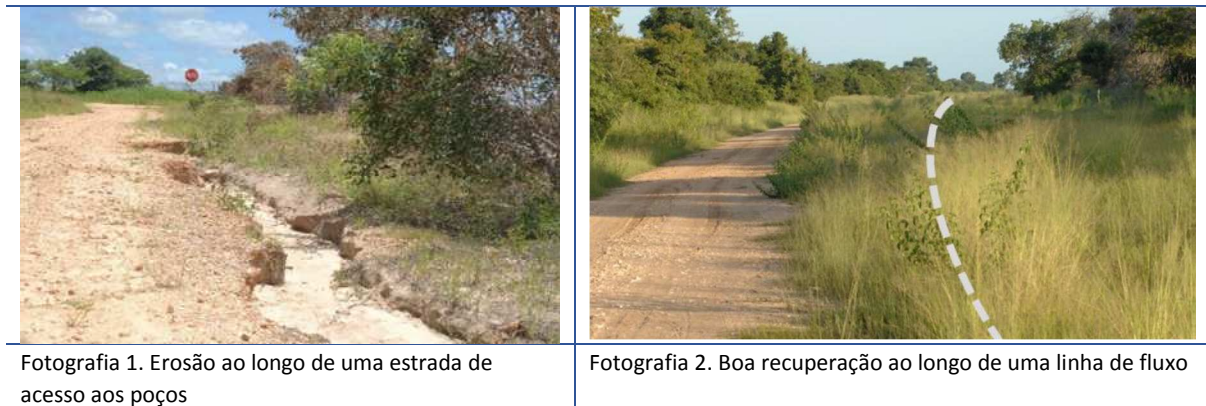
Figura 5-3. Fotografias de exemplos de erosão na berma de estradas e de recuperação de linhas de fluxo ao longo da Estrada de acesso existente
